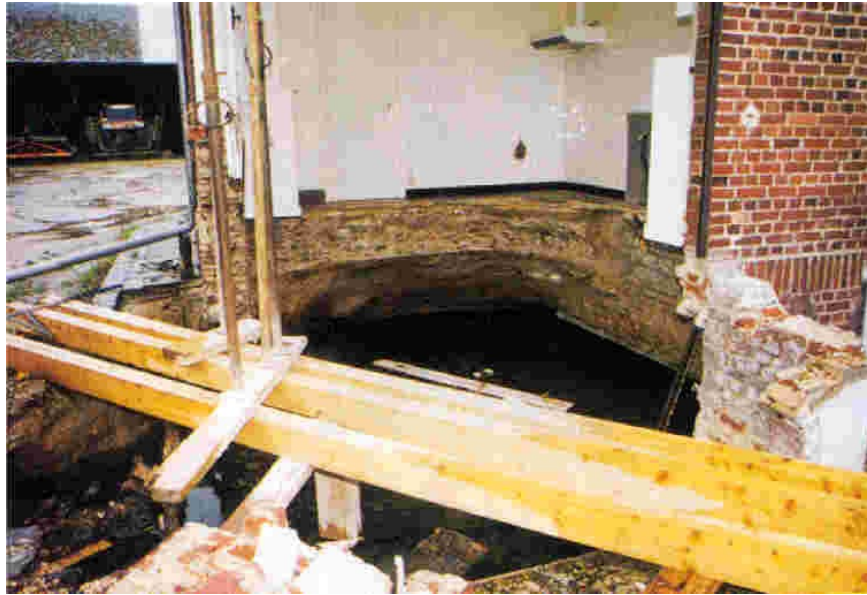
Fig.6 : Effondrement d'une cavité sous une structure de surface
